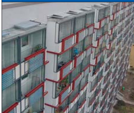
Abb 9: Röhrenkollektoren als Fassadenelemente
